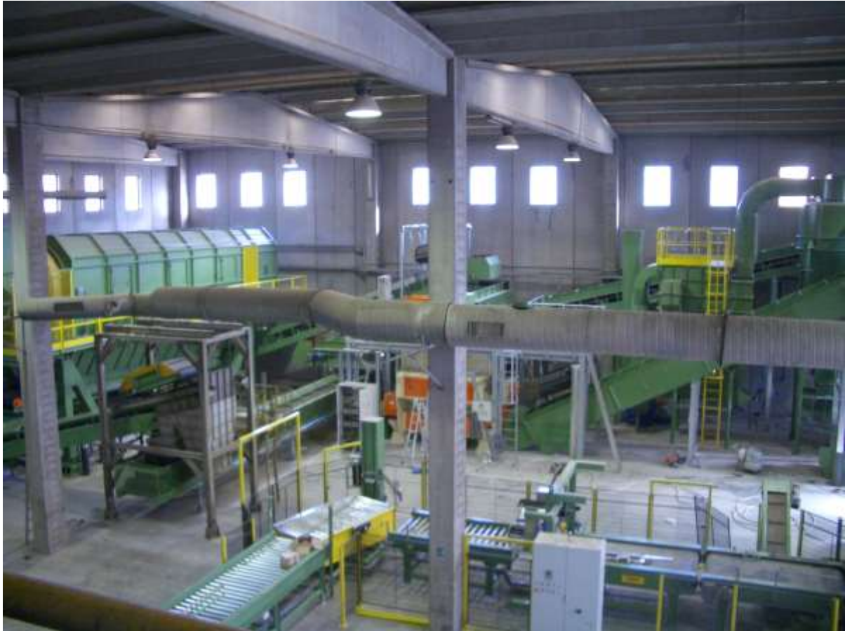
Impianto di selezione meccanica dei rifiuti urbani – Potenzialità 30 ton/h
