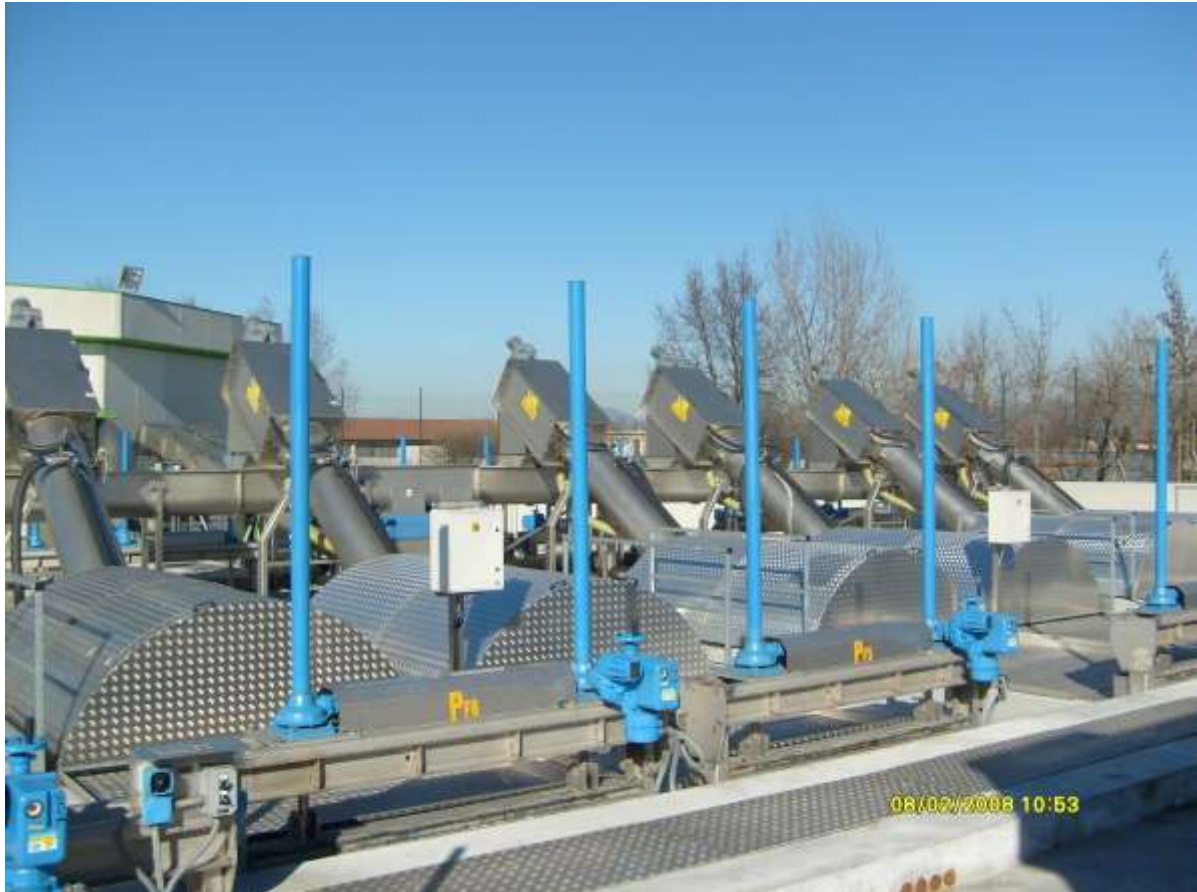
Impianto di depurazione a fanghi attivi – Pretrattamenti – Potenzialità 400.000 a.e.
